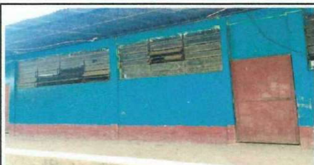
Sustitucion de vidrios quebrados ya que representan un riesgo para los alumnos
